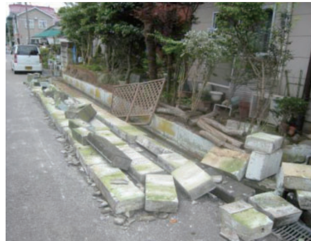
倒壊した石塀
